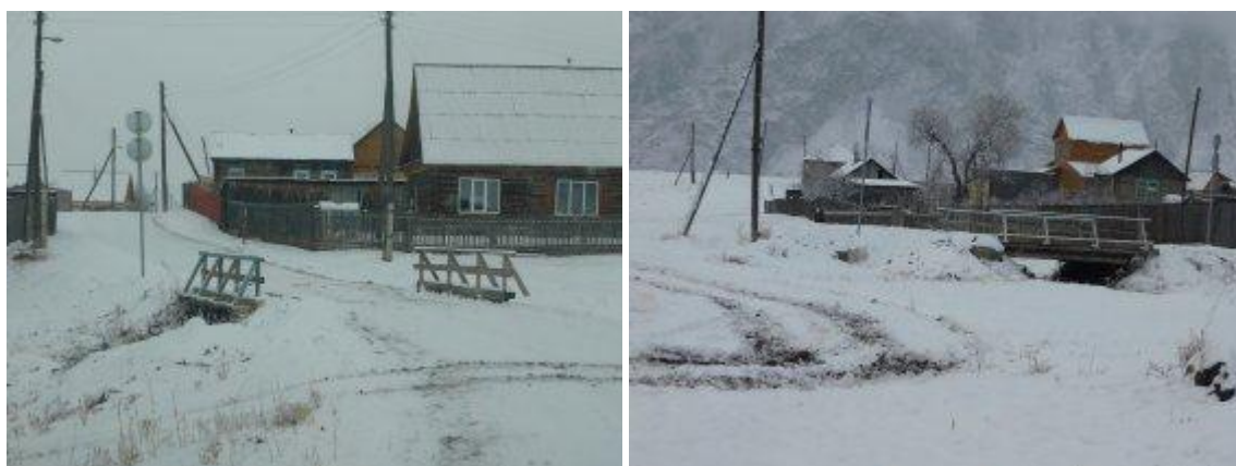
Рис. 2.- Автомобильный мост на ул. Центральная с. Куяс Куяского сельского поселения (требуется новое строительство к концу периода планирования)
